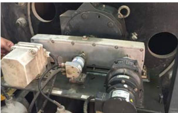
Vorher: Verteilergetriebe mit mechanischem Kopierwerk, Absolutwert-Drehgeber und mechanischem Fliehkraftschalter / Before: Distribution gear with mechanical cam limit switch, absolute encoder and mechanical overspeed switch
